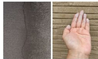
壁のひび割れ 手に白い粉がつく
